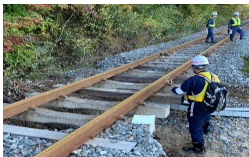
※1 路盤流出に係る被害状況の調査
